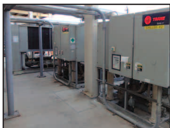
(3) Trane 125 & 170 Ton Chillers
